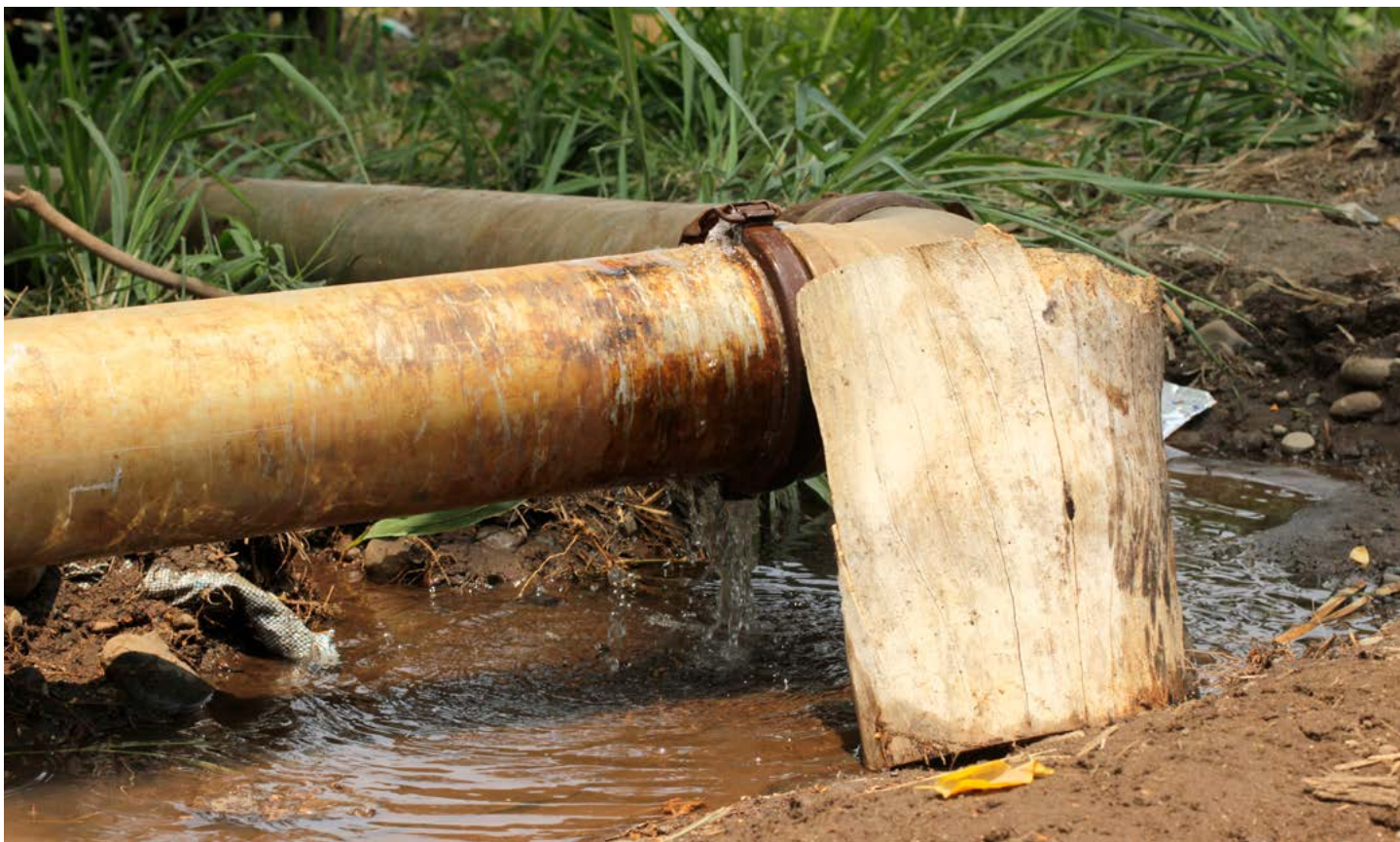
Fuga de agua en la tubería de las empresas cañeras, mientras las comunidades vecinas no tienen agua, Champerico, 3.05.2023.
